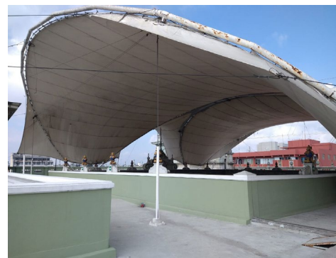
Panorámica del techo que cubre el Patio de la Paz, que muestra daños severos en estructura metálica y en las membranas.
