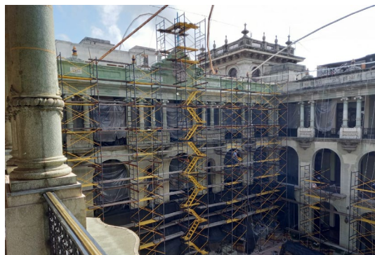
Fachada norte del Patio de la Cultura se encuentra en proceso de restauración
